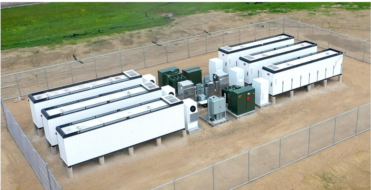
Bild 7.5 Ett exempel på Alliant Energys 5 MWh batterilagringssystem (Alliant Energy Corp.).
